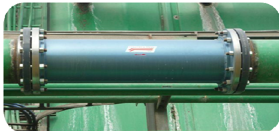
Instalacja na chłodni kominowej, Generacion Mediterranea, Prowincja Cordoba, Argentyna
